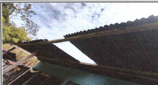
Foto 2: El cambio de estructura y cubierta se realizara por deterioro en estructura de madera
